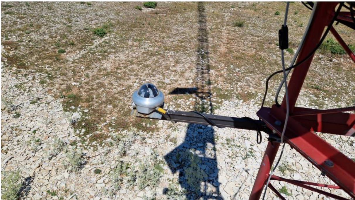
Slika 6-4 Piranometar Delta-T Sunshine montiran na mjernom stupu
